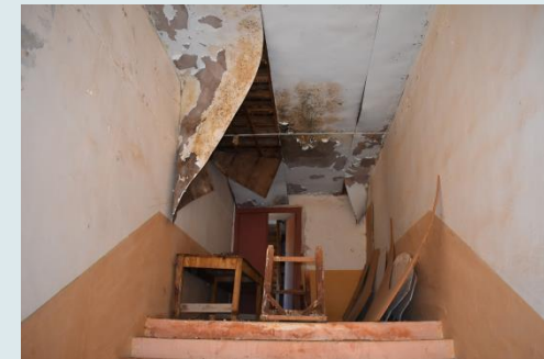
Κατάρρευση ταβανώματος στη στοά
