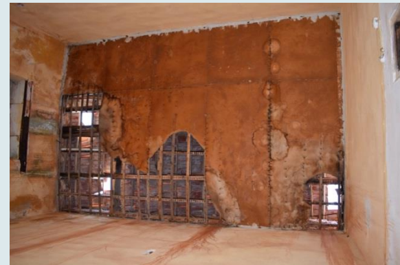
Κατάρρευση ταβανώματος κεντρικού κλιμακοστασίου
