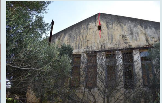
Κάθετη ρωγμή στην κορυφή της στέγης
