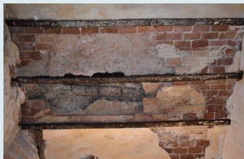
Οξειδωση σιδηροδοκών, αποκόλληση του κονιάματος και πτώση των οπτόπλινθων
