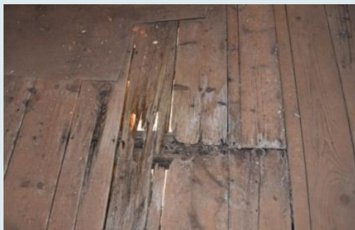
Σανίδες πατώματος ορόφου που έχουν καταστραφεί
