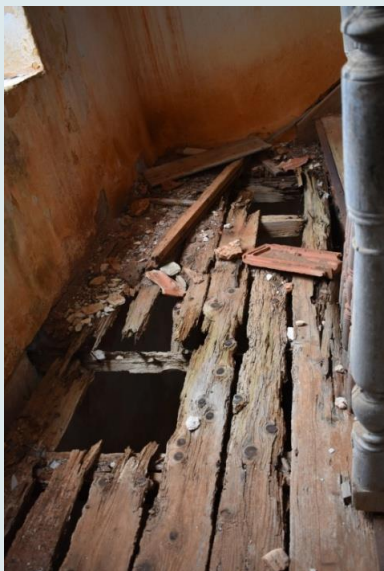
Κατεστραμμένες σανίδες στο πλατύσκαλο
