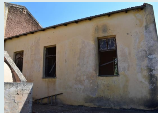
Αποσάθρωση κονιάματος και υγρασία στο νότιο τμήμα του κτηρίου
