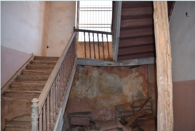
Ανερχόμενη υγρασία στον Ανατολικό τοίχο του κεντρικού κλιμακοστασίου
