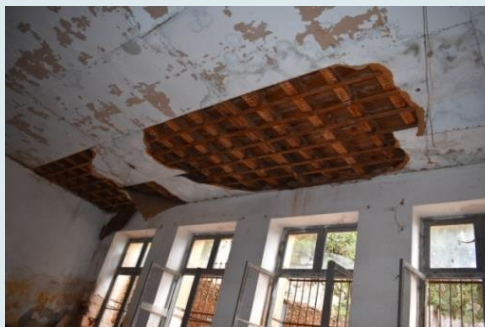
Κατάρρευση ταβανώματος σε αίθουσα του ισογείου
