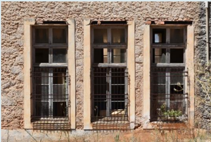
Οξείδωση σιδηροδοκών στα υπέρθυρα
