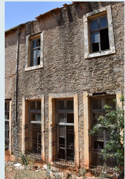
Υγρασία στην Ανατολική όψη λόγω κατεστραμμένης υδρορροής
