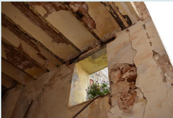
Αποσάθρωση και αποκόλληση κονιάματος στην οροφή και στην τοιχοποιία της στοάς
