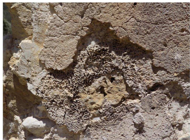
/4/ Δυτική (ασκεπής) πλευρά Βόρειας όψης- Κυψέλωση από δράση αλάτων στο υποκείμενο της τοιχογραφίας κονίαμα βιολογική αποκία
