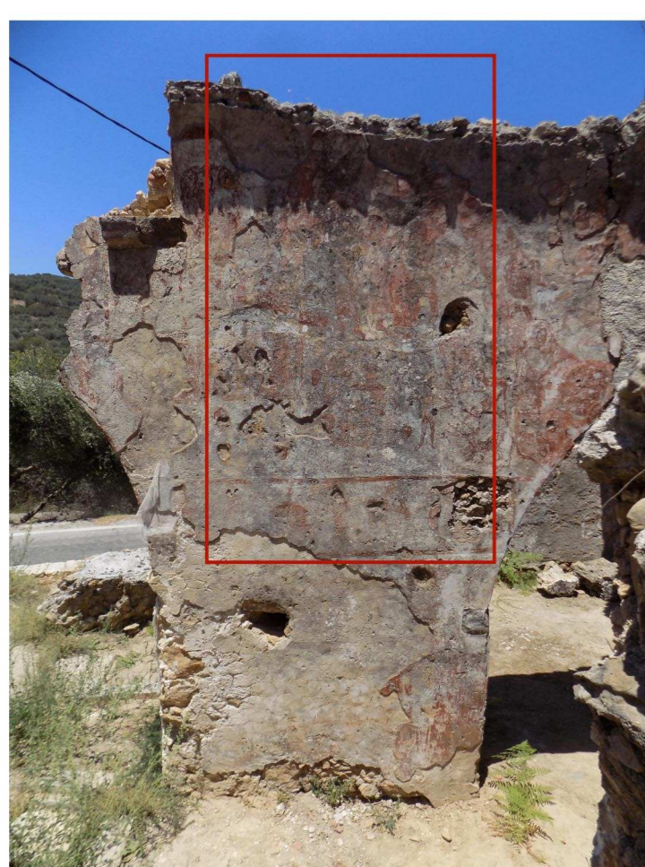
/1/ Δυτική (ασκεπής) πλευρά - Βιολογική γκρι επικάλυψη λόγω κατερχόμενης υγρασίας από το νερό της βροχής
