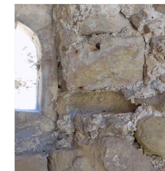
/3/ Έντονη κυψέλωση σημειακά, χαρακτηριστική εικόνα λίθου που έχει έρθει σε επαφή με τσιμεντοκονίαμα- κρυπτοεξάνθηση αλάτων
