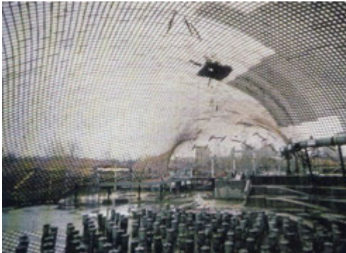
Εικ. 4.19: Εσωτερική φωτογραφία από την φάση της κατασκευής στην οποία φαίνονται τα βάρη που χρησιμοποιήθηκαν για τον στατικό έλεγχο του κελύφους.
